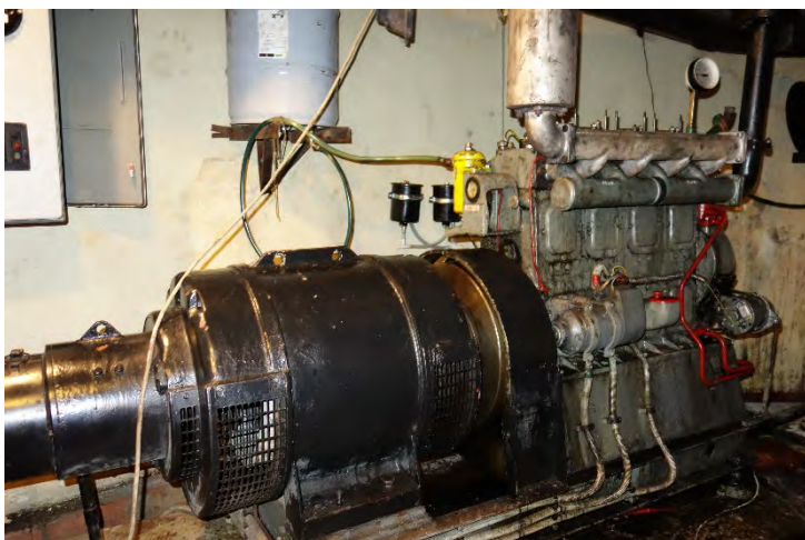
Atomový kryt, srdce atomového krytu, dieslový agregát, sobota 9. dubna 2016
