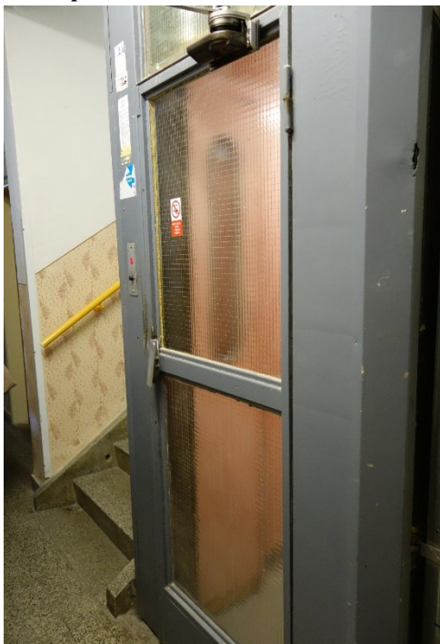
Starý nevyhovující výtah v bytovém domě na ulici Kubelíkova 10.
