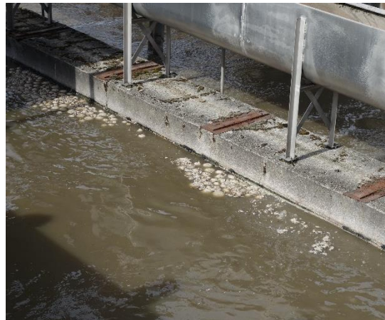
Voda, která vytéká z budovy hrubého předčištění má do čisté hodně daleko.
