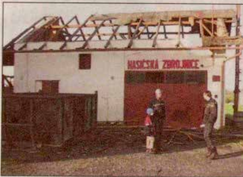
Životičtí dobrovolní hasiči Mojmir Stachura (vlevo) a velitel sboru Česlav Baron při zahájení demoličních prací. foto: JOSEF PINTÉR
